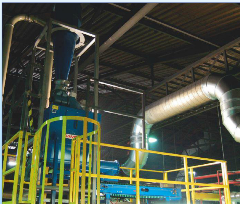
Het bordes bovenin de hal, met links de hopper en rechts de weegband
